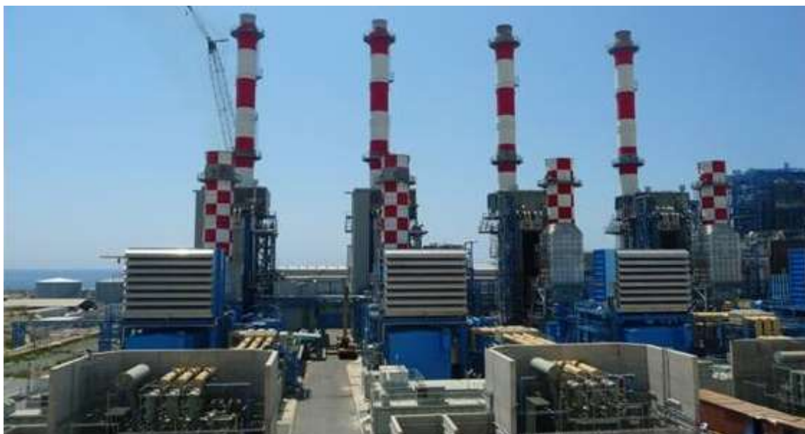
Εικόνα 3.3: Μονάδες ηλεκτροπαραγωγού σταθμού της ΑΗΚ
